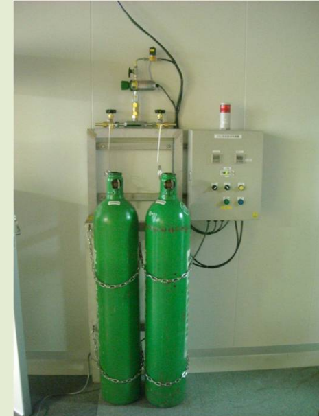
<液化炭酸ガス供給装置>
